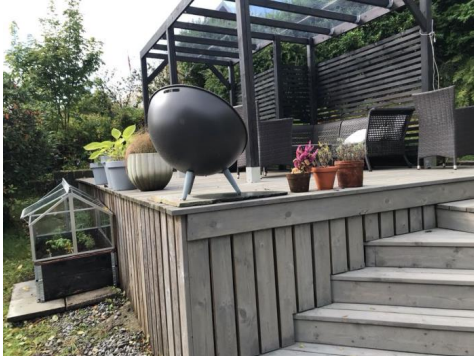
Bilde viser terrasse uten rekkverk
