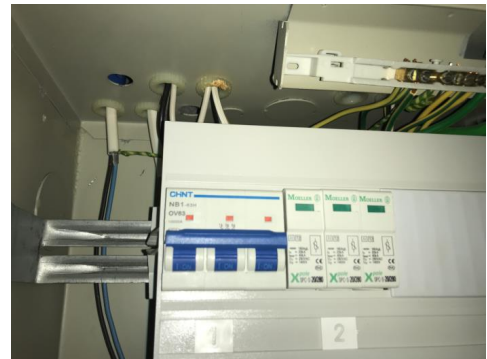
Bilde viser en av åpningene i sikringskapet.
